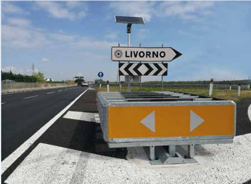
Bild 5: Überwachungssystem Geronimo auf der Straße hinter einem Aufprall-dämpfer installiert
